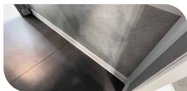
Revestimiento interior de PVC
